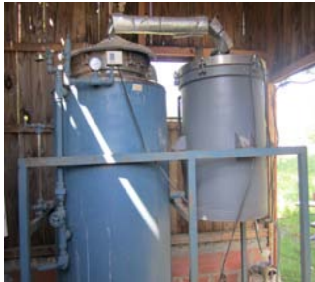
Destilador para obtención de aceites esenciales EEJH-FCAyF-UNLP
