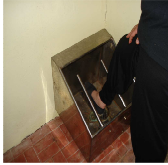
Implementos de los Filtros Sanitarios
